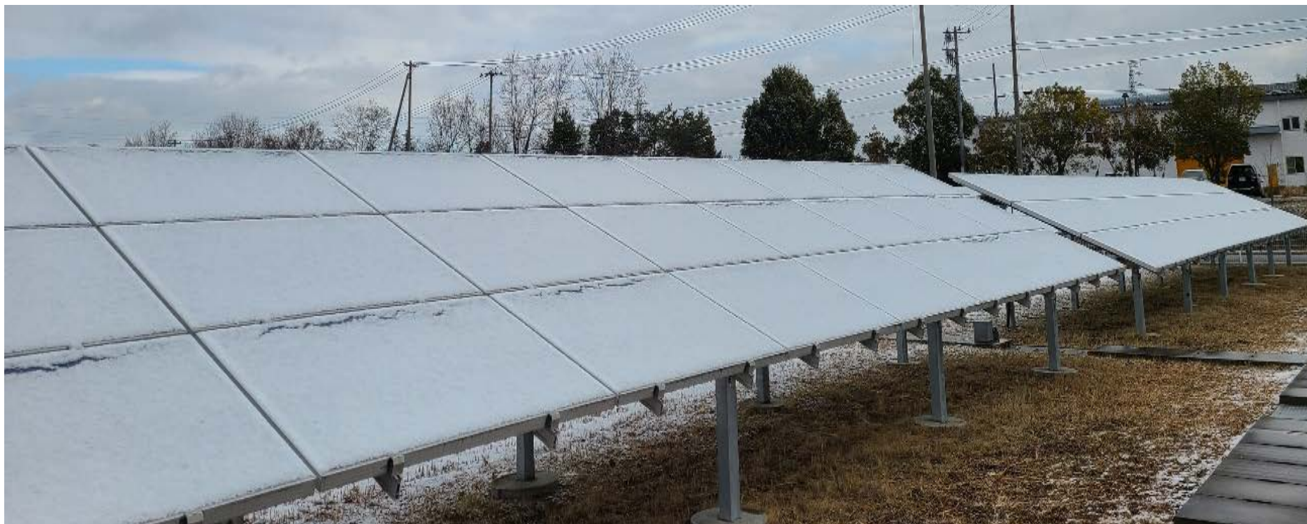
積雪が認められる太陽光発電システム（産総研 福島再生可能エネルギー研究所にて著者が撮影）
